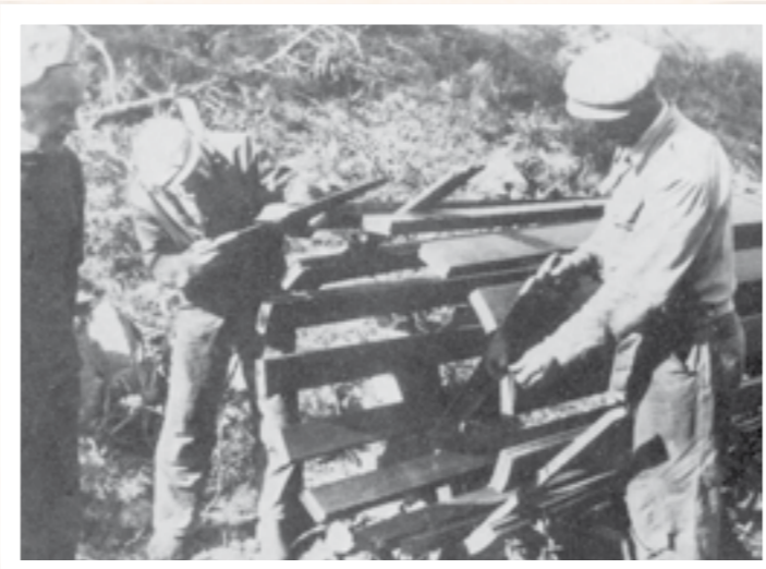
Bilde viser bygging av turbinrør i tre, ved Åvella 1952. Dette var samme type som røret mellom "Inntekten" og Veadammen (post 10).
